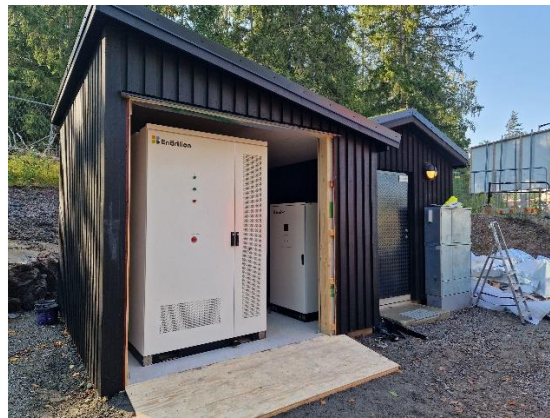
Figur 12: Reservkraft via energilager i en avloppstation. Bildkälla Sollentuna Energi o Miljö
