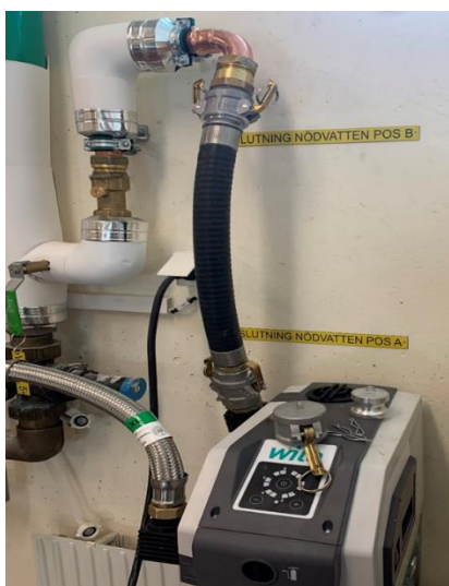
Figur 6: Pump för trycksättning av nödvatten (Bildkälla: Jönköpings kommun)
